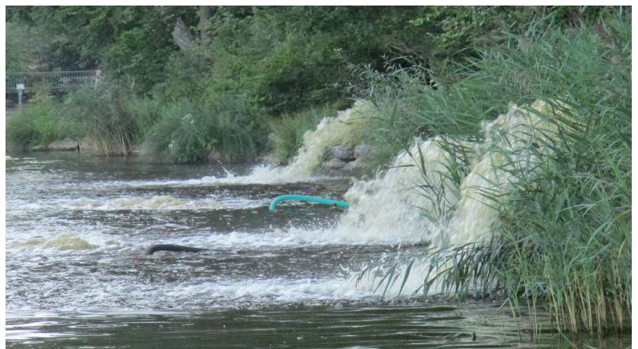
Bei einer Pumpleistung von bis zu 21 000 Liter pro Minute entstehen große Sprudel
