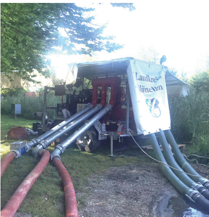
Die hochtechnisierte Pumpenanlage
