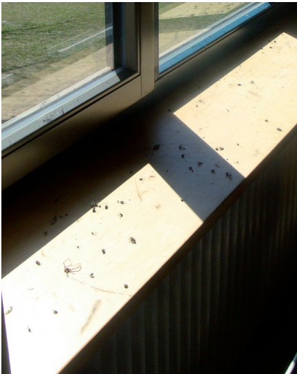
Ins Gebäude eingedrungene tote Fliegen
