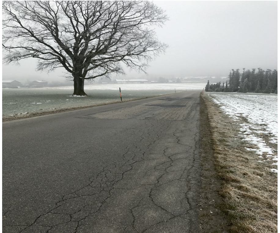
Die Straße „An der Lein“ zwischen Holzhausen und Ebertshausen
