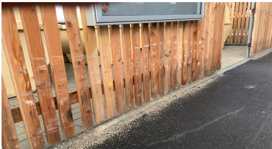
Die neuen Staketten sind schwer beschädigt. Besonders verwerflich in diesem Fall die Fahrerflucht.
