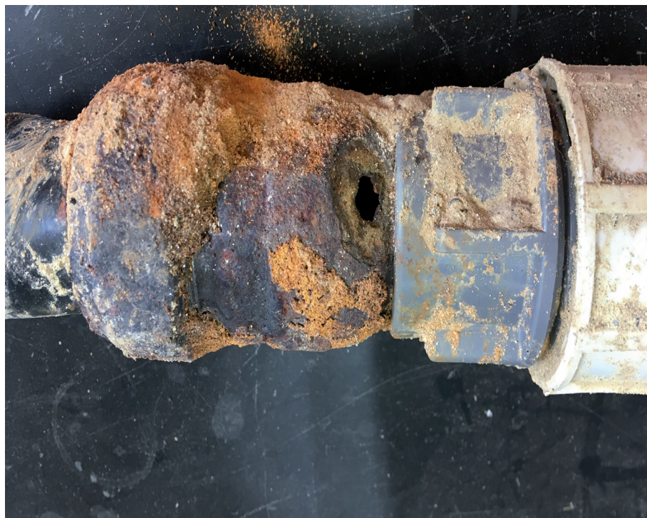
Der Übeltäter - gut sichtbar das Loch, durch das binnen tagen tausende Liter verloren gehen können
