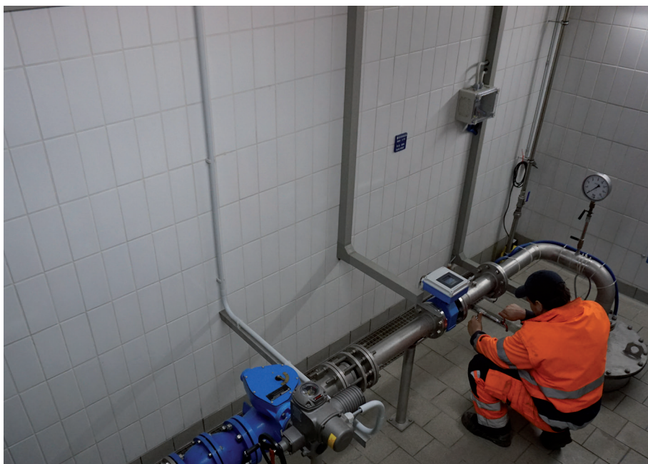
Der Wassermeister Manuel Kluge im Brunnen Holzhausen
