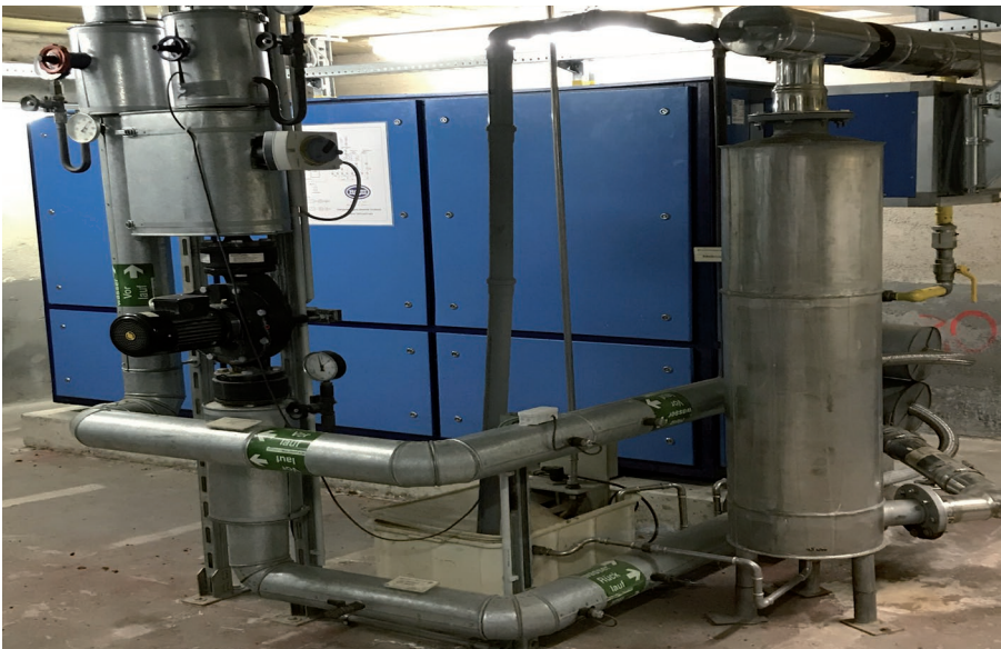
Das Blockheizkraftwerk im Rathaus der Gemeinde Straßlach-Dingharting
