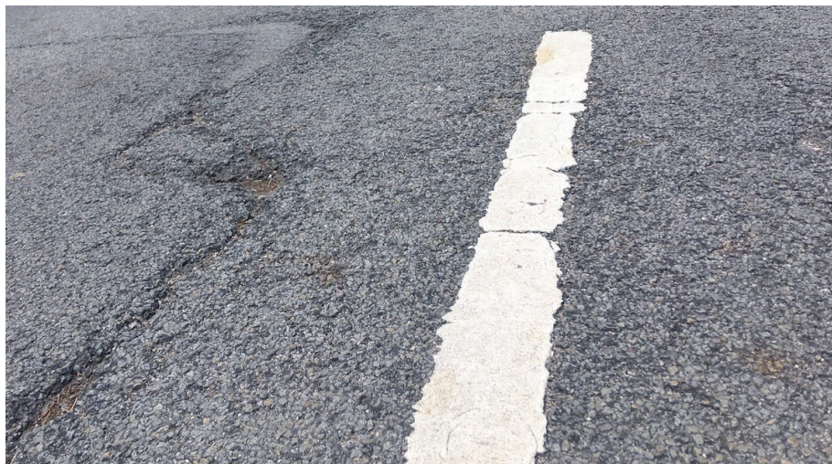
Der Zustand der Staatsstraße ist so schlecht, dass Anwohner durch die drüber scheppernden und rasseln- den Fahrzeuge in ihrer Nachtruhe gestört werden.
