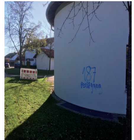
Mit völlig dämlichen Texten und linkischen Schmierereien wurde Schaden in beachtlicher Höhe verursacht.
