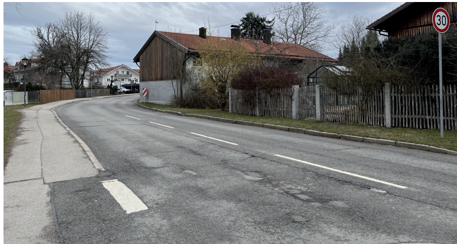
Die Ortsdurchfahrt in Straßlach hat schon bessere Tage gesehen und muss saniert werden. Die Unebenheiten und Schlaglöcher sorgen nicht zuletzt dafür, dass der Verkehrslärm mehr stört als er müsste.
