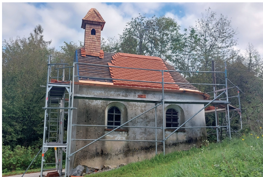
So hat es angefangen: Die kleine Kirche war stark baufällig, die Wände waren feucht und das Fundament drohte einzustürzen.
