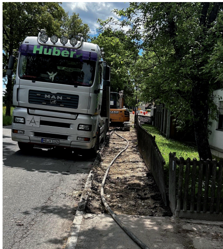
Der Ausbau der Stromleitungen erfolgt in allen Spannungsebenen.
