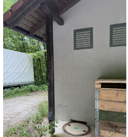
Der Verkehrszähler wurde von der Stütze abgerissen und gestohlen.
