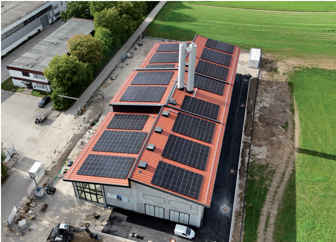
Das gesamte Dach des Heizwerkes wurde mit PV-Anlagen ausgestattet.
